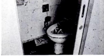
汚物が詰まったトイレ
